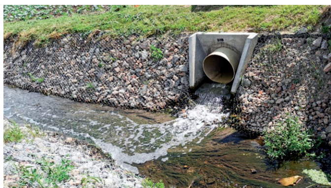
Wylot ścieków oczyszczonych z oczyszczalni „Zamienie”
