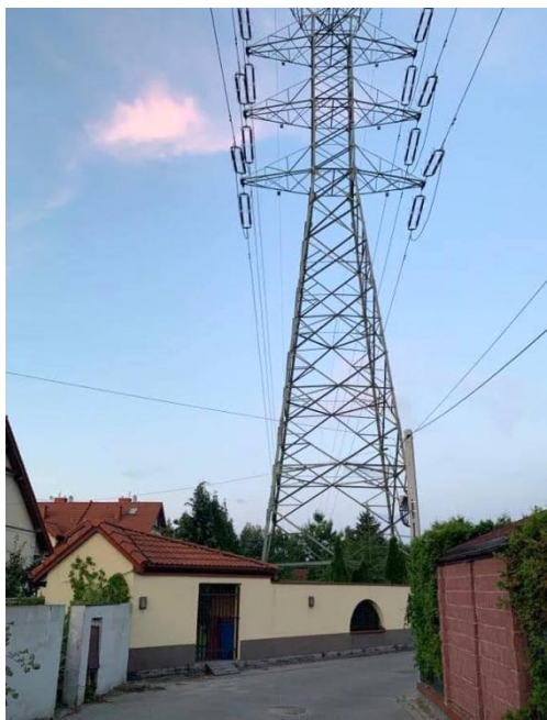
Fot. 2 Linia elektroenergetyczna 220 kV (źródło: „Opracowanie ekofizjograficzne (...)”)
